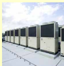
高性能ヒートポンプ空調
