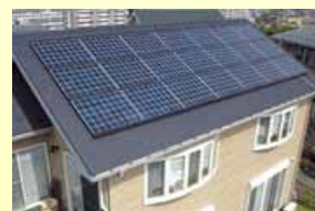
太陽光パネル
