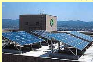
太陽光パネル
